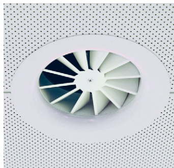
Lüftung F0, F30
