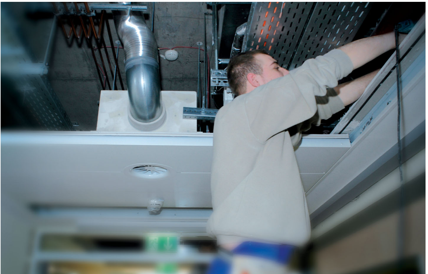
Lüftungsanschluss in F30
