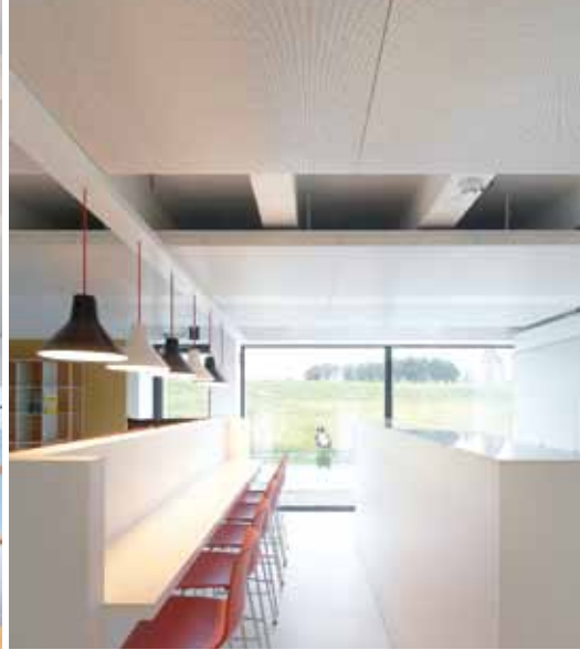
FUNKTION. Für eine optimale Raumakustik in den Büro- und Besprechungsräumen sorgen die Segel in Perforation 320 mit integriertem Akustikvlies.
