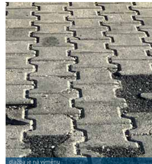
dlažba je na výměnu
